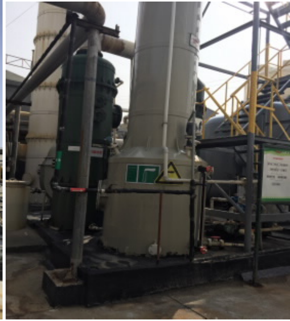
污水站废气排放处理装置
