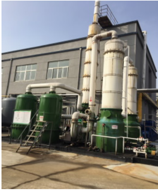
车间废气排放集中处理装置
