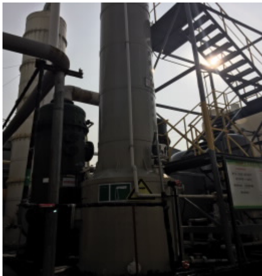
污水站废气排放处理装置
